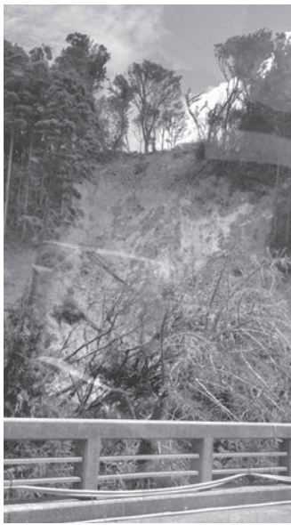
9月豪雨災害による土砂崩れの様子
